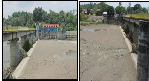
Gambar 1. Sedimentasi yang Tinggi di Hulu Bendung Krueng Aceh (Foto 12 Juni 2016)
