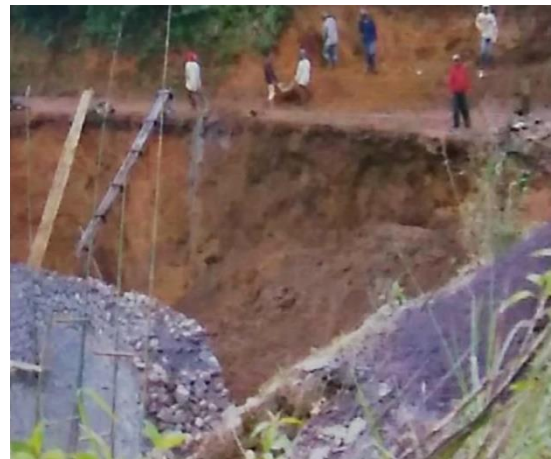
Gambar 3. Longsor Tipe Gelinciran Tanah di Kec. Banjarwangi
